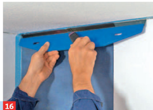
16 Mit dem Tapezierspachtel* die Tapete in die Ecke drücken und den Überstand zur Decke entlang des Spachtels abschneiden.
